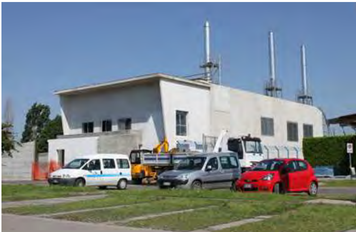
CENTRALE DI COGENERAZIONE E TELERISCALDAMENTO
